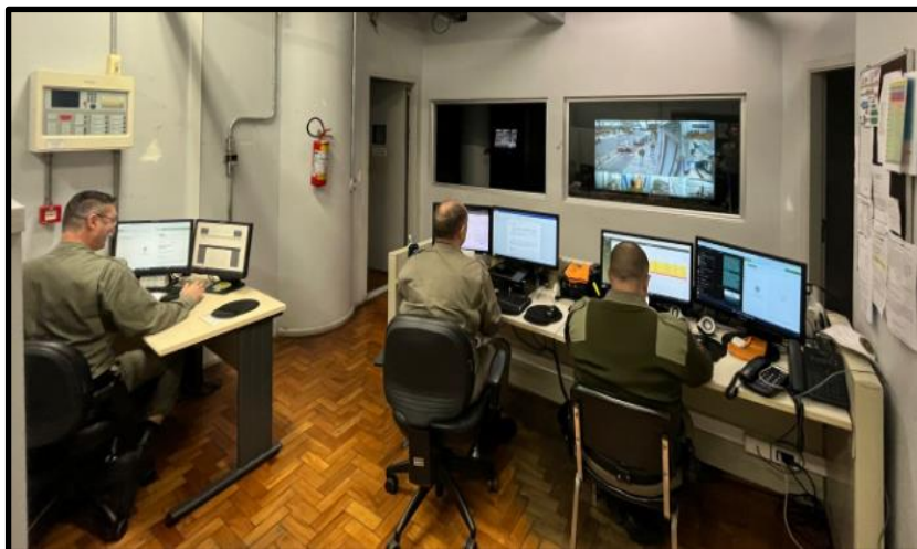
Figura 50 – Sala de Operações e Videomonitoramento da Cor-G
